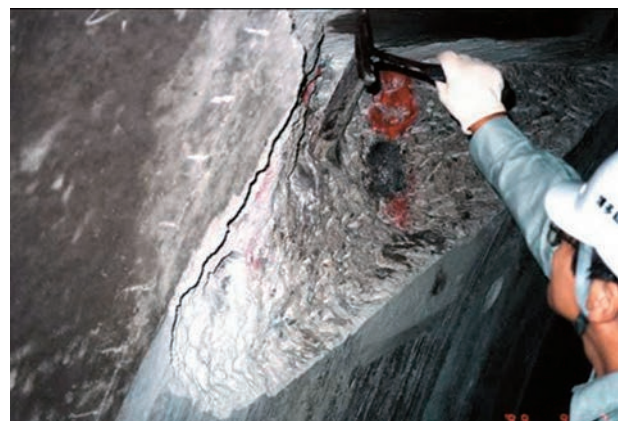
写真1 福岡トンネルで落下した二次覆工コンクリート
