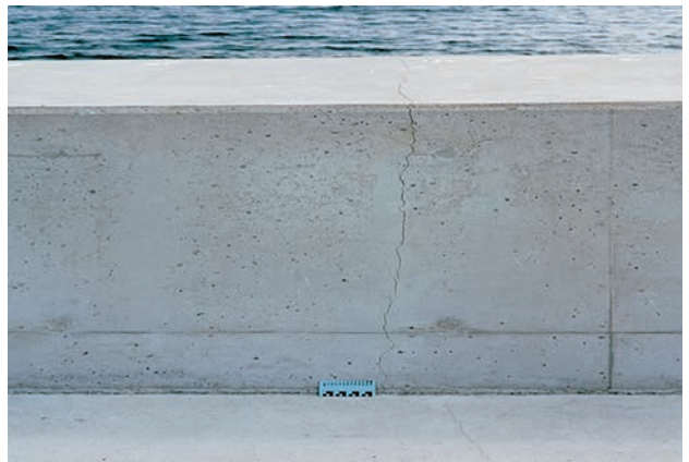
写真2 セメントの水和熱に伴うコンクリートの温度ひび割れ
