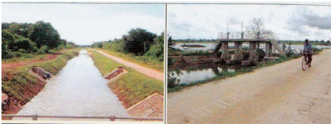
張り芝の法面水路(左)と渡橋部のコンクリート法張り部(右)
