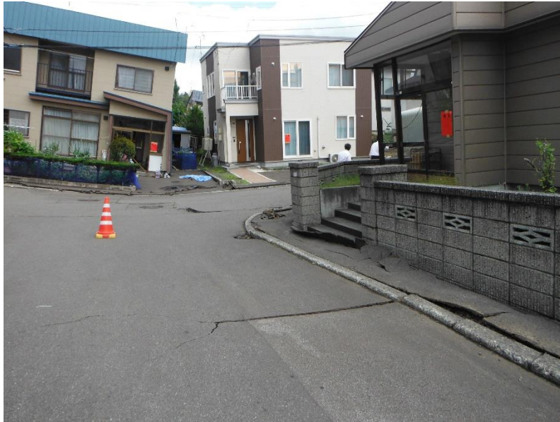
写真-5 札幌の盛土造成地の陥没
